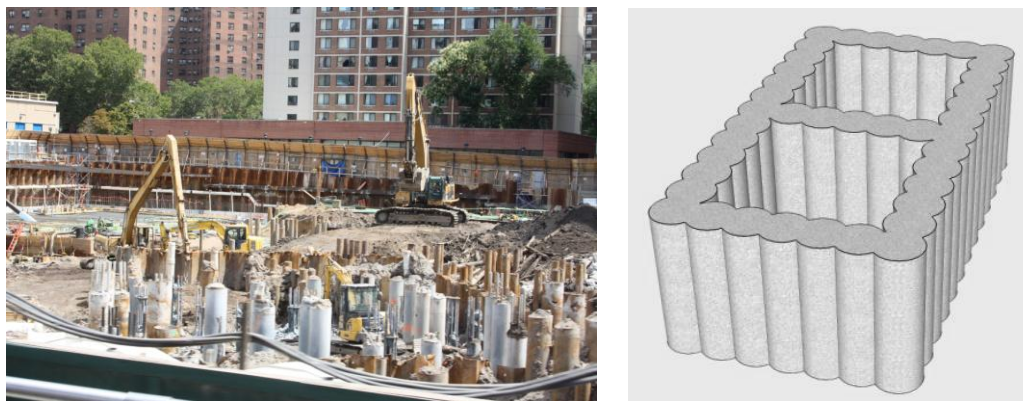
Figure 1. A gauche. Sols structurés constitués de pieux et micropieux (Brûlé et al. , 2015).
