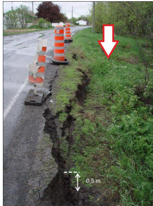
Figure 1. Vue de la fissure avec rejet, apparue le 17 mai 2011.
